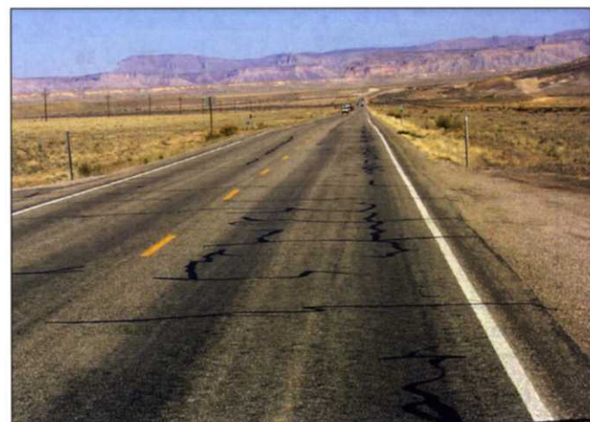
Рис. 2. Усталостные и температурные трещины на дороге местного значения в штате Юта: пересекающиеся усталостные трещины по полосам наката на промежуточной стадии формирования сетки «крокодилова кожа», когда поперечные трещины уже связаны с продольными, но еще не образуют замкнутых многоугольников; поперечные низкотемпературные трещины пересекают всю или почти всю проезжую часть; трещины залиты горячим вязким битумом.
